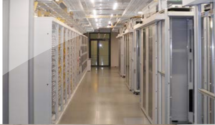
Swisscom Zürich-Binz Breitbandlabor, Bereich Datencenter >
